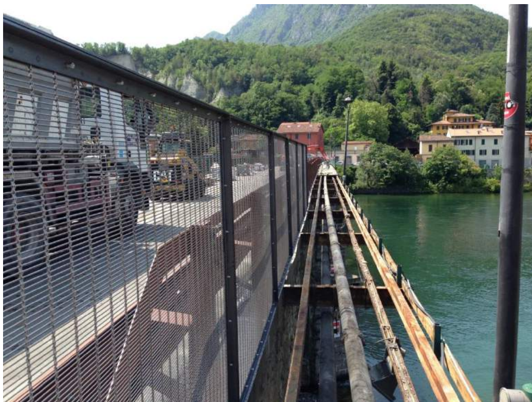
Impianti ancorati alle strutture metalliche
