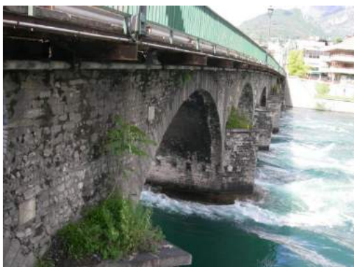
Le arcate del Ponte Azzone Visconti con in evidenza le passerelle pedonali a sbalzo
